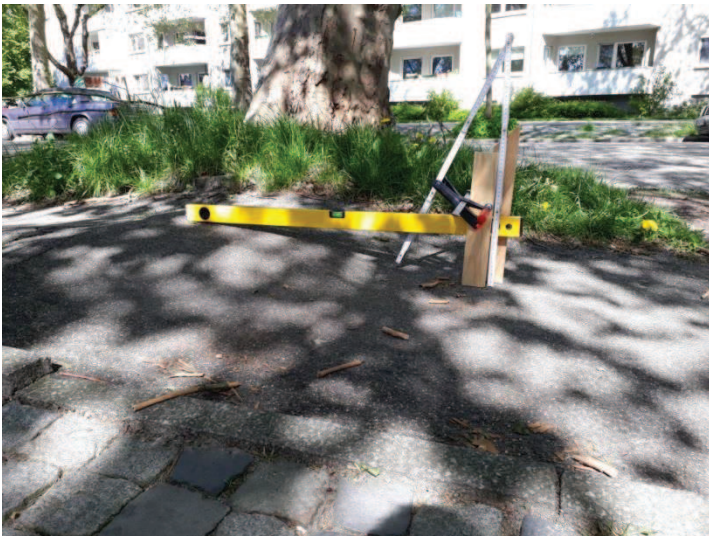
Foto 2: Messung der Höhe des Wurzelaufruchs mittels Wasserwaage
