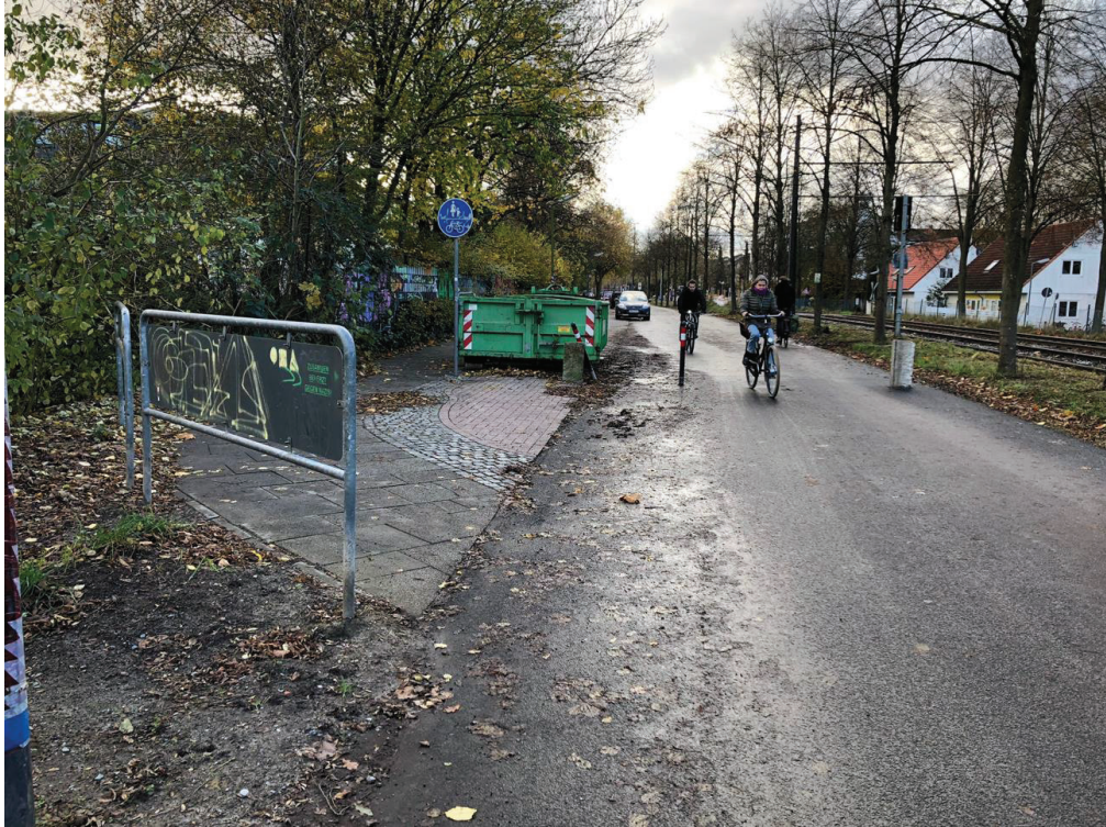
Foto 3: Aus Richtung Universität kommend abzubauen Verkehrszeichen gemeinsamer Geh-/Radweg (VZ 240)
